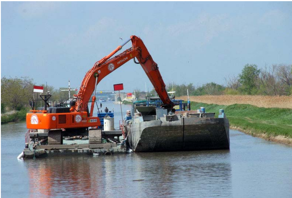
Figure 46 - Exemple de curage mécanique en eau à l'aide d'une pelle sur ponton (Jan de Nul)
